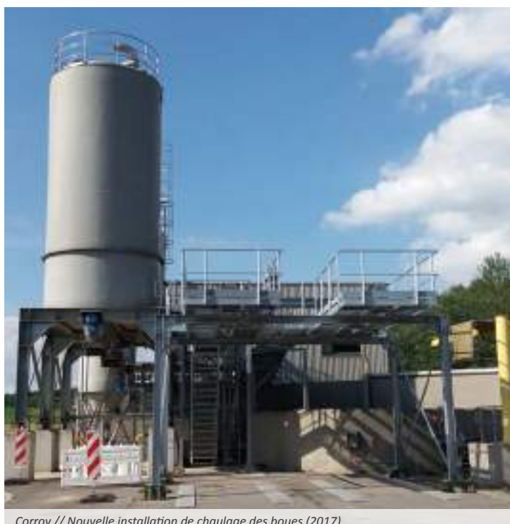
Corroy // Nouvelle installation de chaulage des boues (2017)
