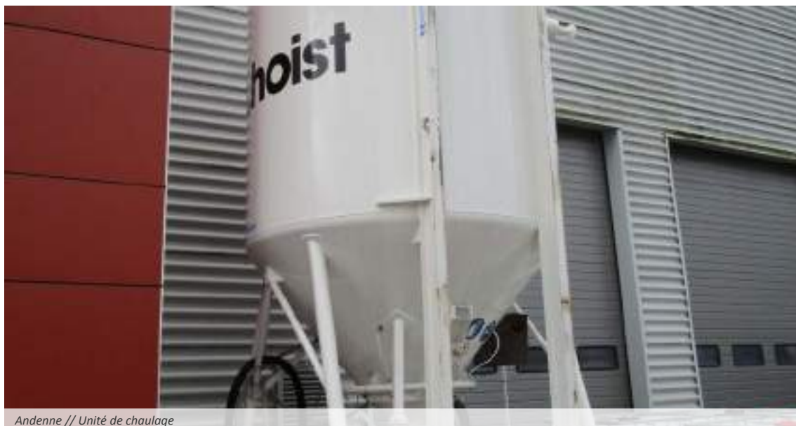
Andenne // Unité de chaulage
