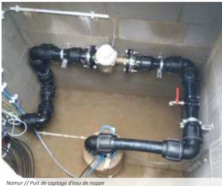
Namur // Puit de captage d'eau de nappe
