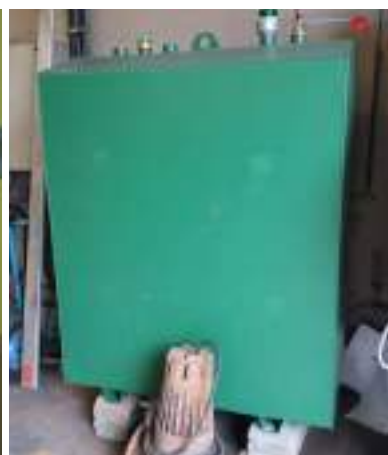
Rochefort // Cuve à mazout avec double encvtement sécurisé en cas de fuite
