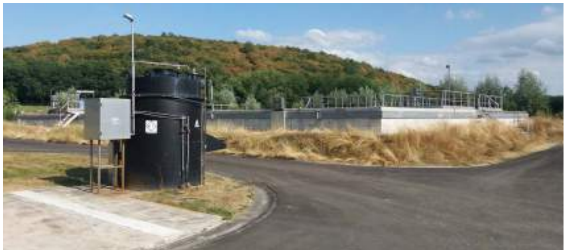
Couvin-Mariembourg // Cuve de chlorure ferrique
