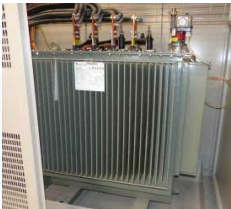
Mornimont // Transformateur d'électricité
