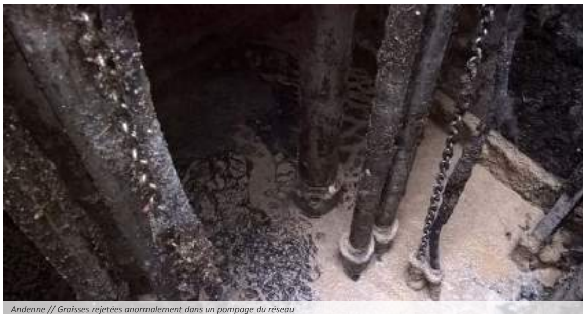
Andenne // Graisses rejetées anormalement dans un pompage du réseau
