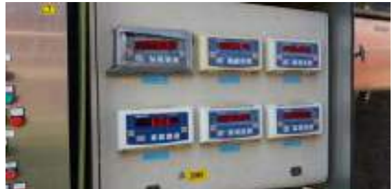
Wépion Profondeville // Pesée des boues déshydratées
