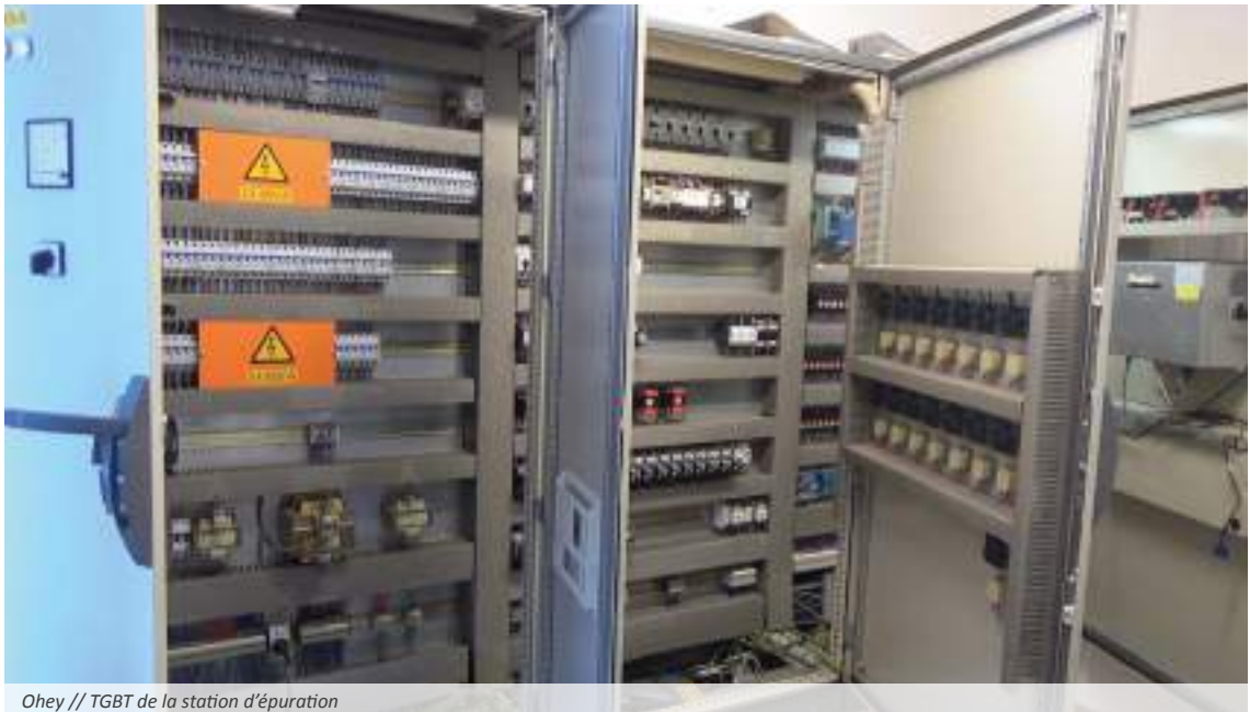
Ohey // TGBT de la station d'épuration
