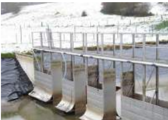
Falaën // Diffuseurs d'air visibles lors de leur placement
