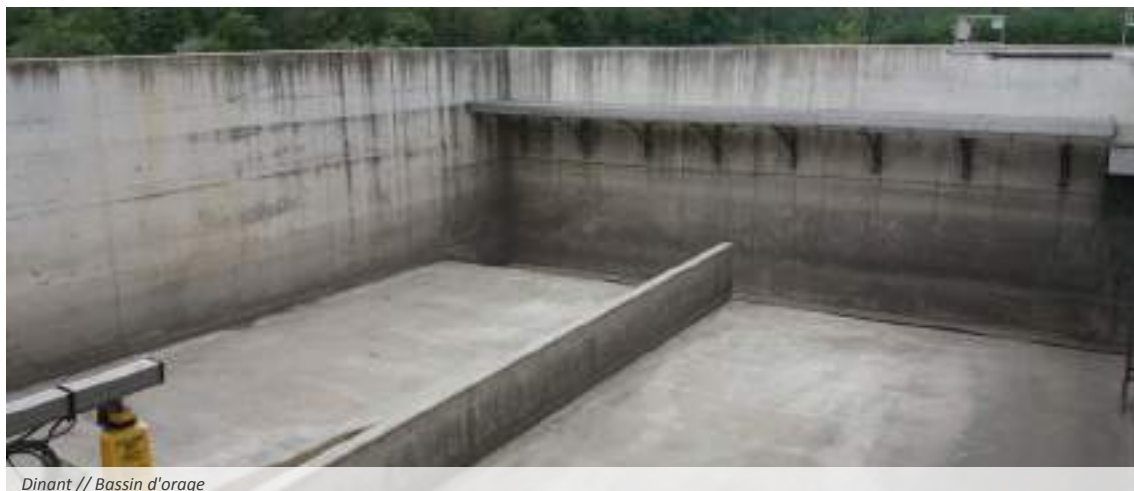
Dinant // Bassin d'orage
