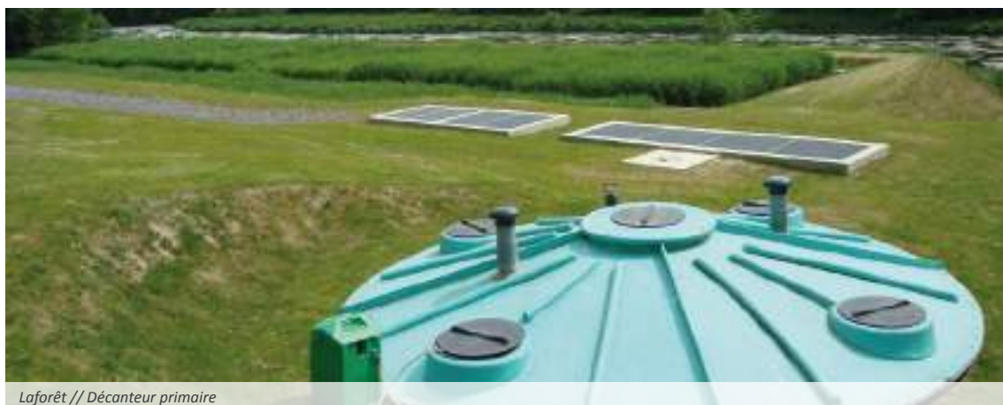
Laforêt // Décanteur primaire
