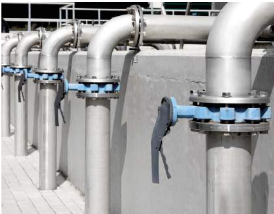
Andenne // Conduites alimentant l'aération du bassin d'activation
