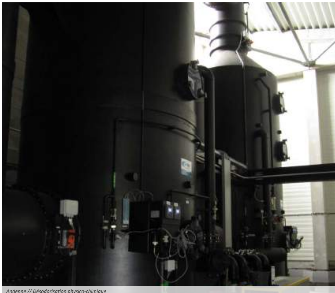
Andenne // Désodorisation physico-chimique
