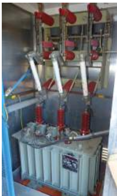
Bièvre // Transformateur d'électricité
