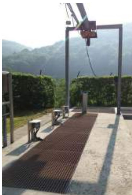
Wépion // Pompage relevage
