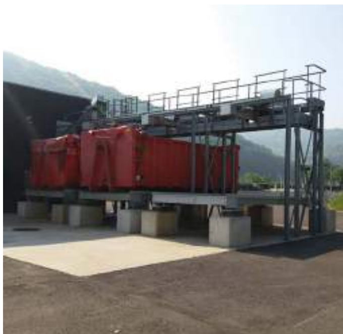
Wépion Profondeville // Conteneurs de boues déshydratées
