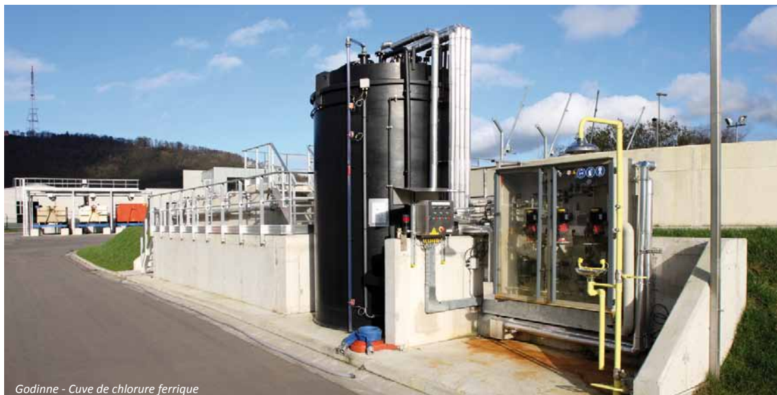
Godinne - Cuve de chlorure ferrique
