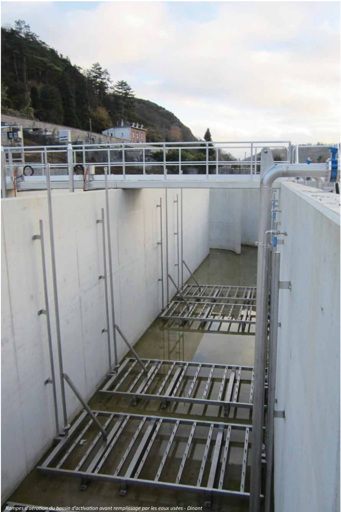
Rampes d'aération du bassin d'activation avant remplissage par les eaux usées - Dinant
