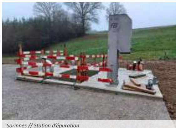
Sorinnes // Station d'épuration
