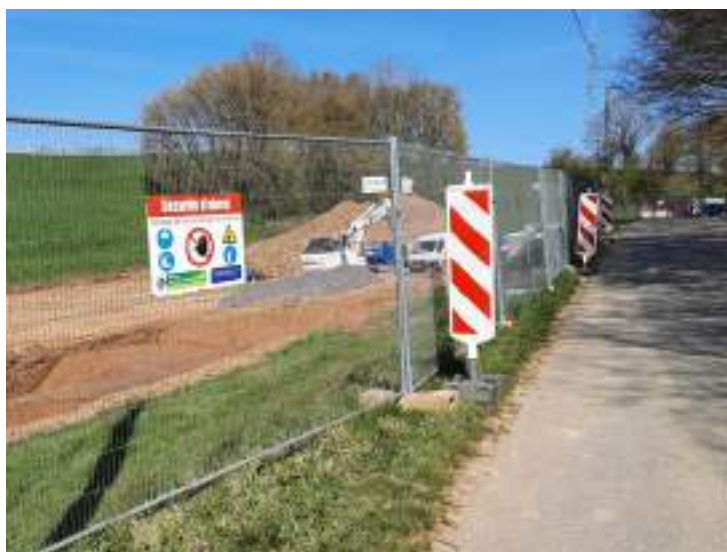
Sorinnes // Station d'épuration
