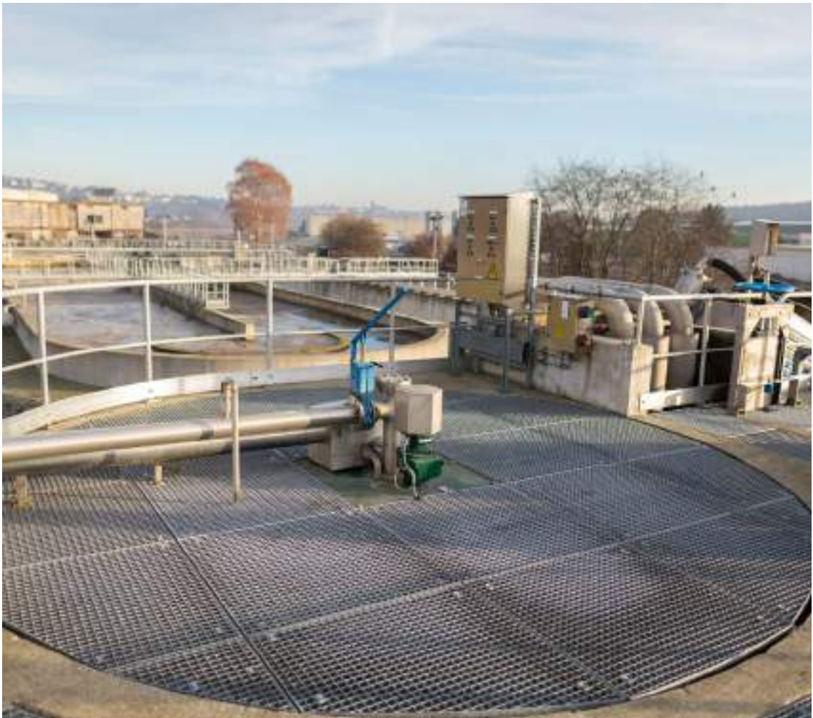
Florefe // Station d'épuration
