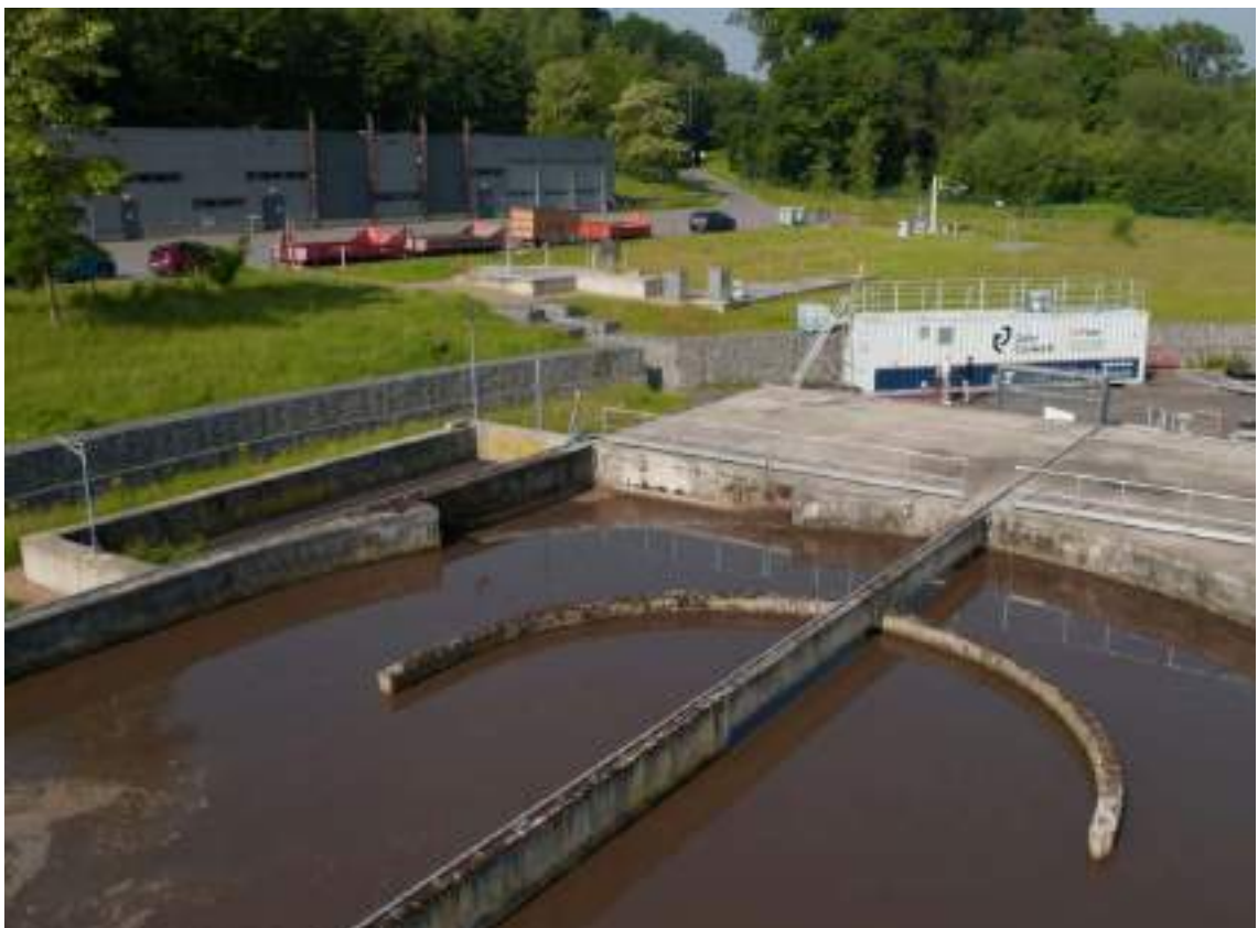
Dinant // BeFlow - Solution de traitement 100 % biologique des eaux usées
