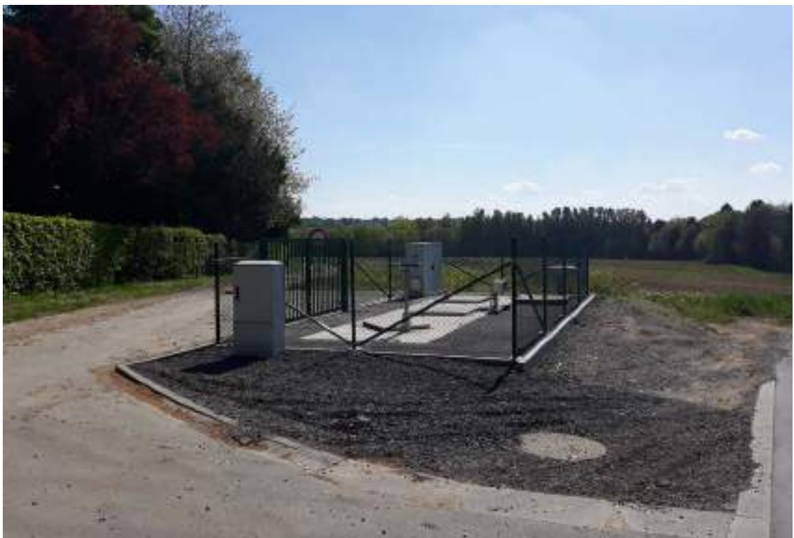
Collecteur de Spontin Dorinne Durnal // Pompage rue Baty de Crock
