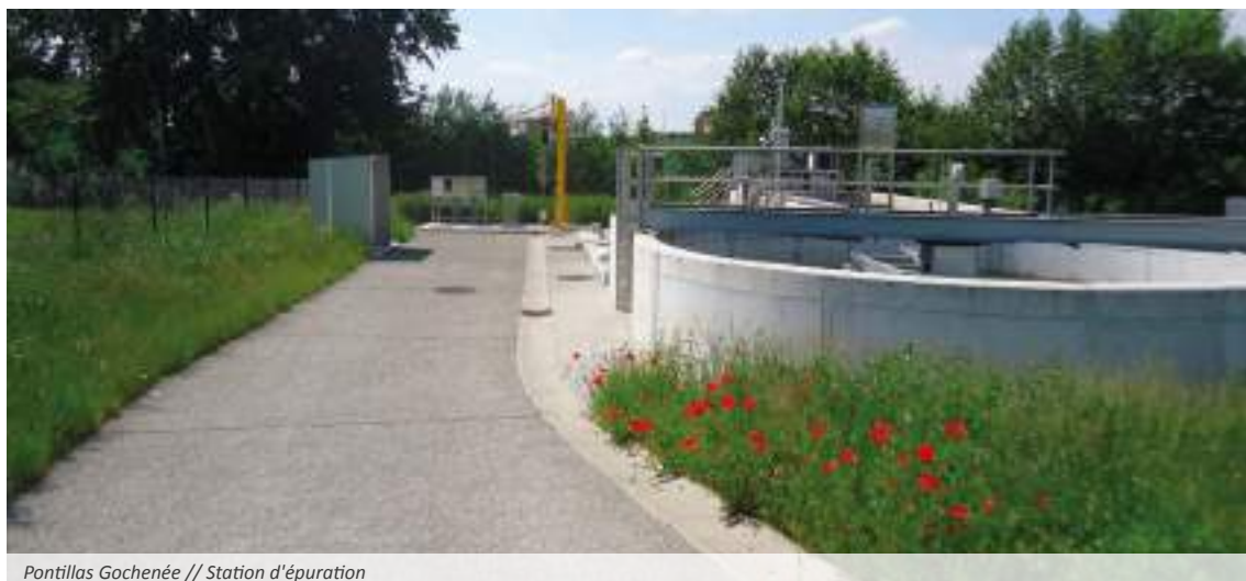
Pontillas Gochenée // Station d'épuration
