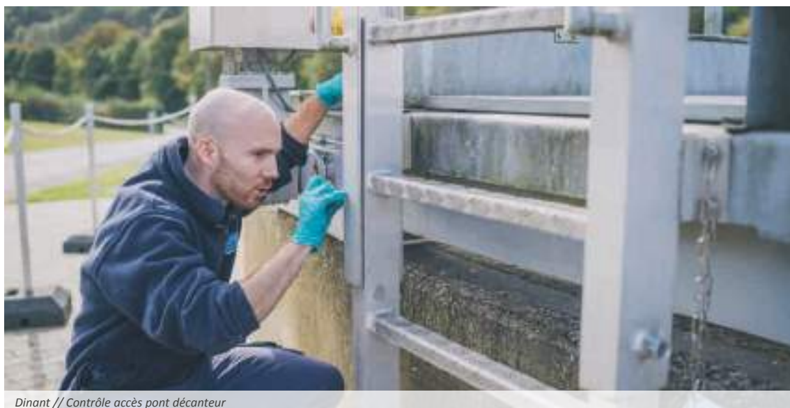
Dinant // Contrôle accès pont décanteur
