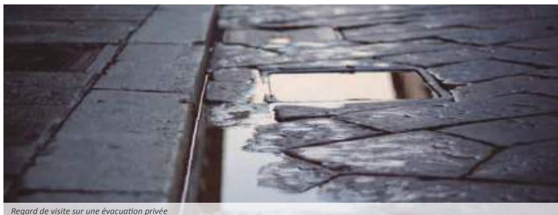
Regard de visite sur une évacuation privée
