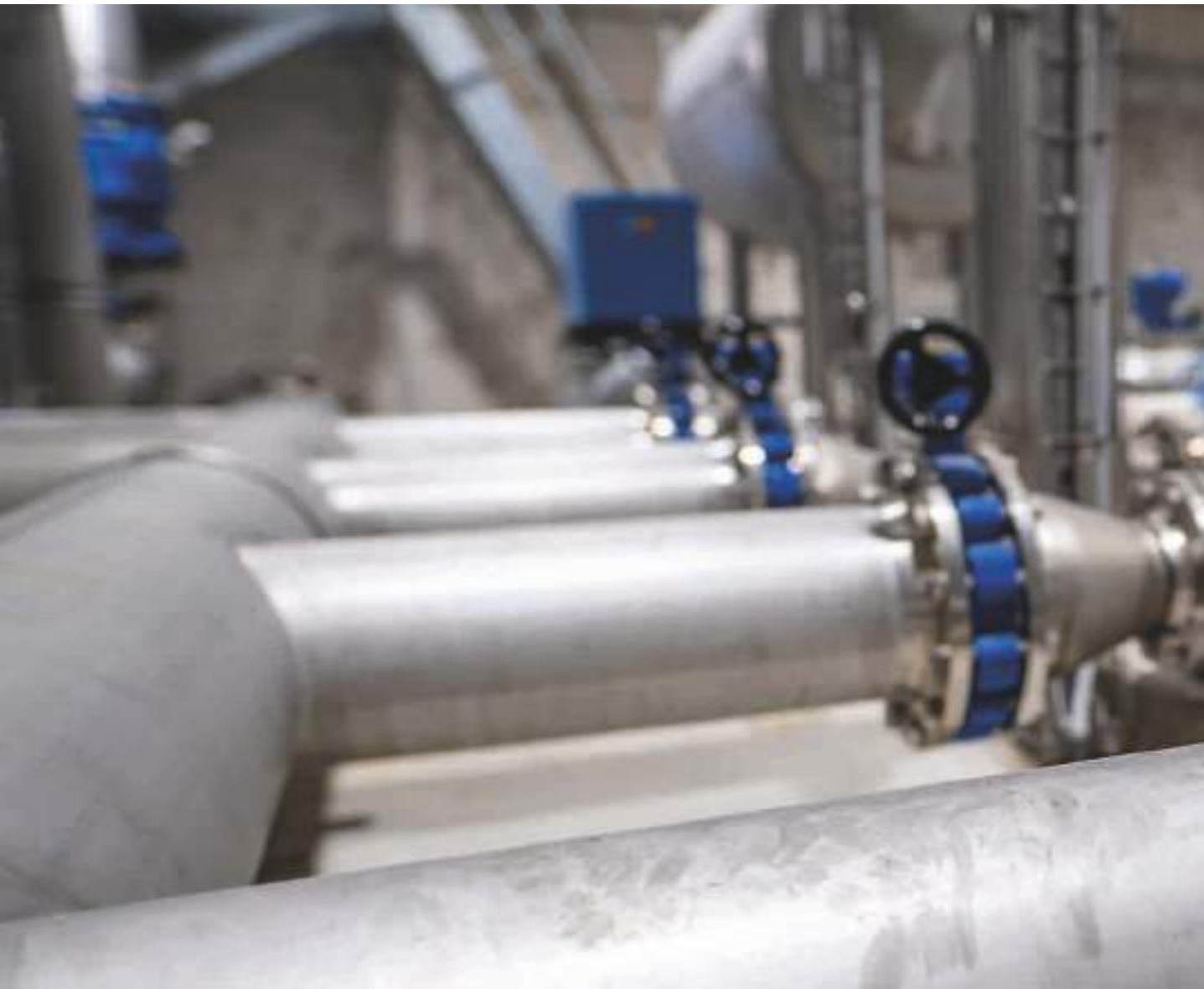
Les Calcaires de Florennes // Station de pompage
