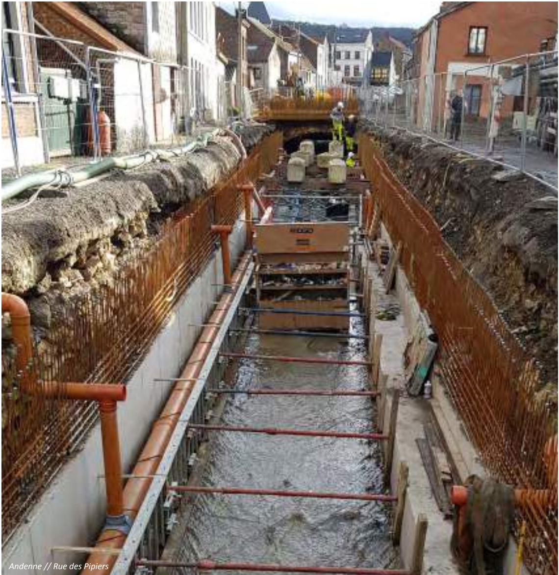
Collecteur de Silenrieux // Réalisation d'un mur en enrochement après le passage du collecteur
