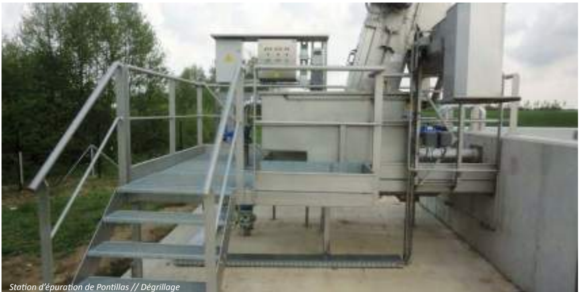
Station d'épuration de Pontillas // Dégrillage
