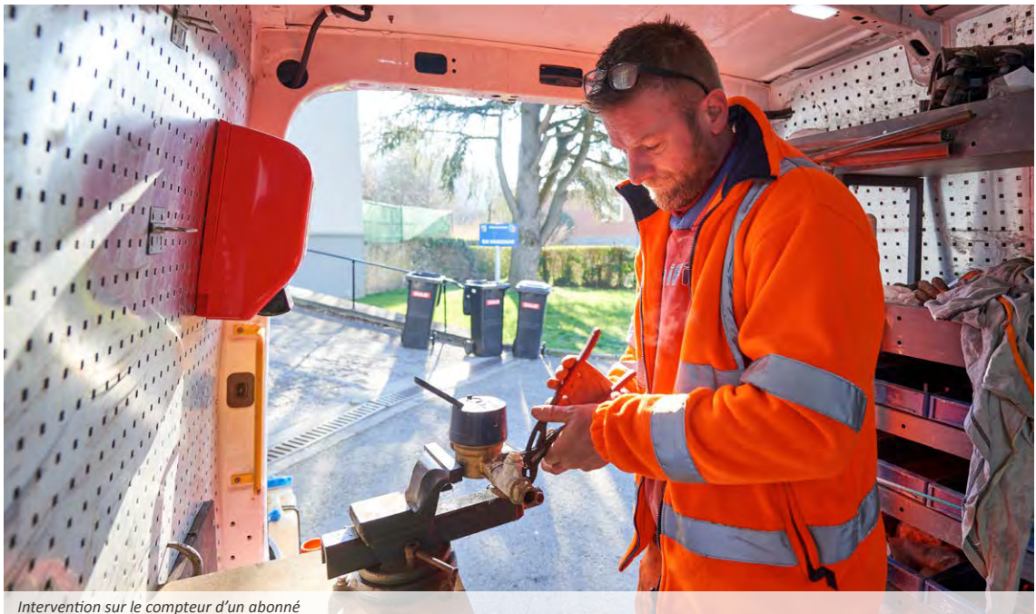
Intervention sur le compteur d'un abonné
