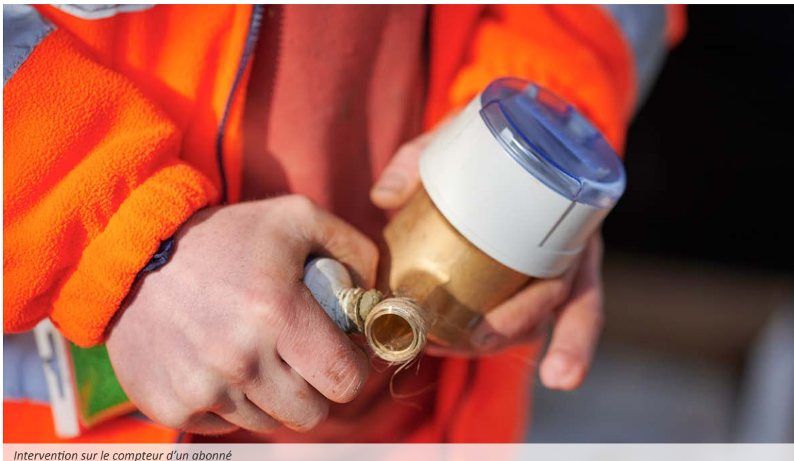
Intervention sur le compteur d'un abonné
