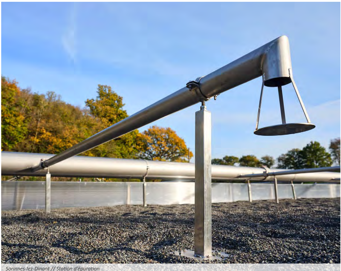
Sorinnes-lez-Dinant // Station d'épuration
