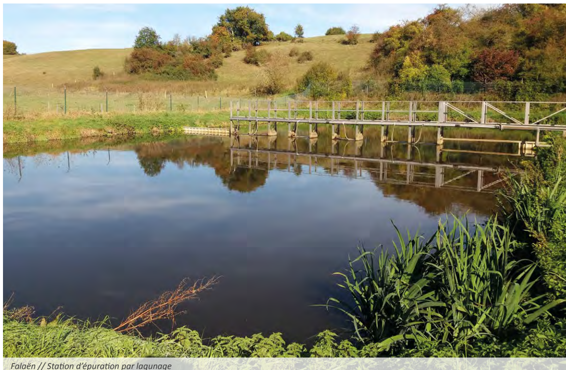
Falaën // Station d'épuration par lagunage
