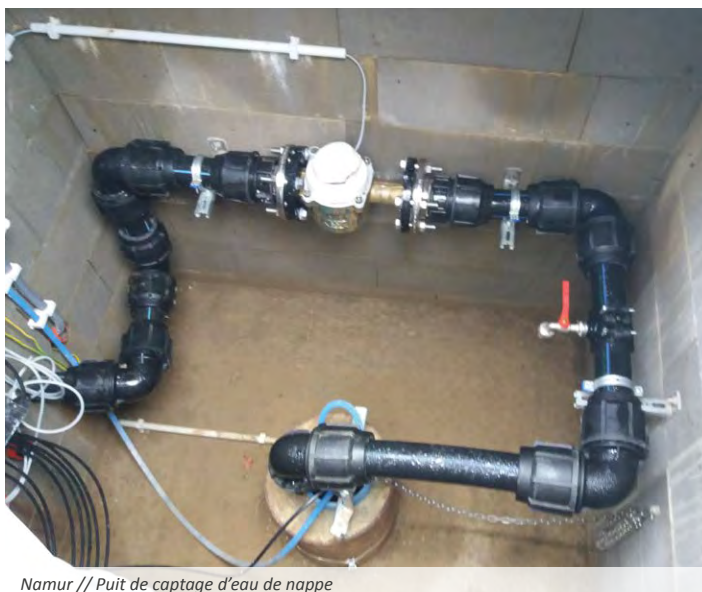
Namur // Puit de captage d'eau de nappe
