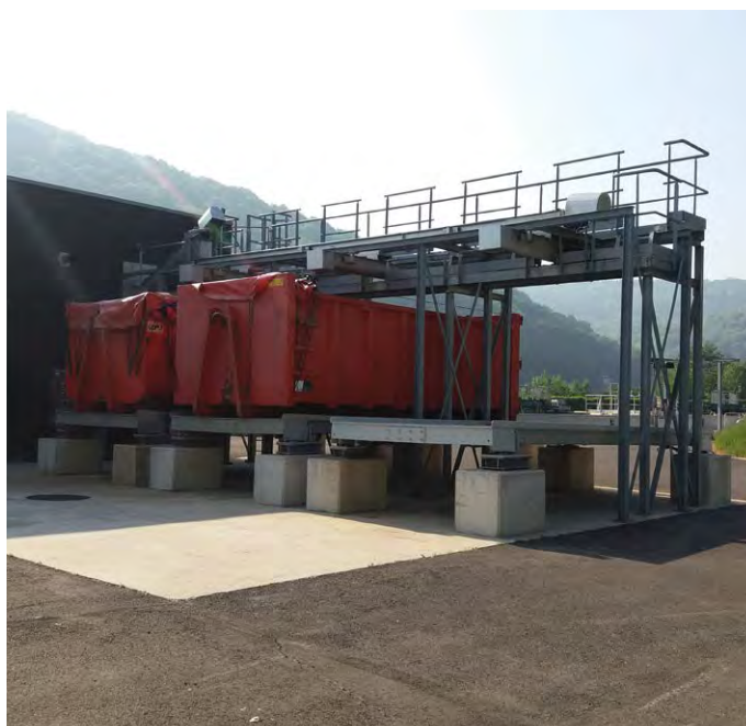
Wépion Profondeville // Conteneurs de boues déshydratées
