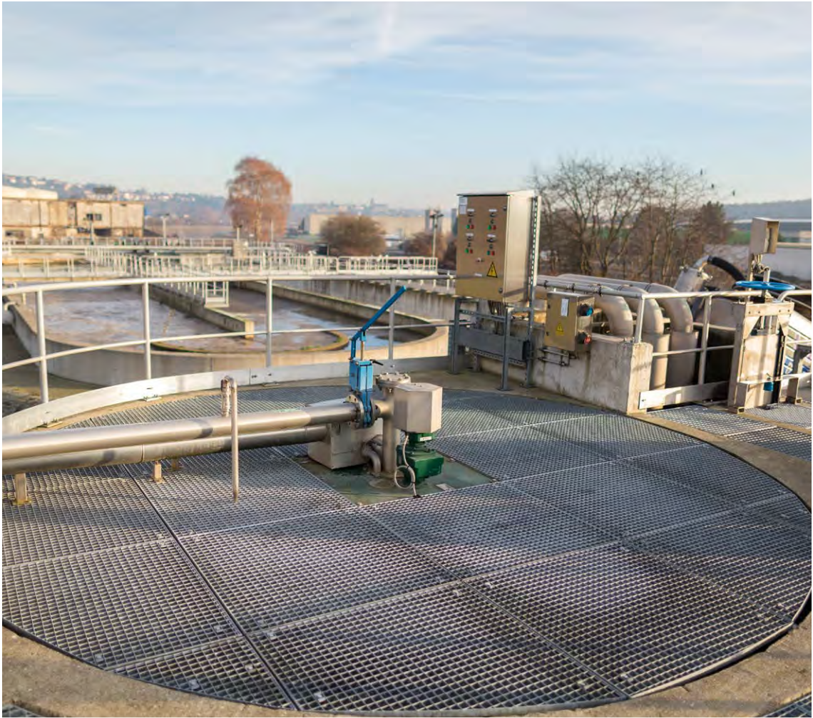
Floreffe // Station d'épuration
