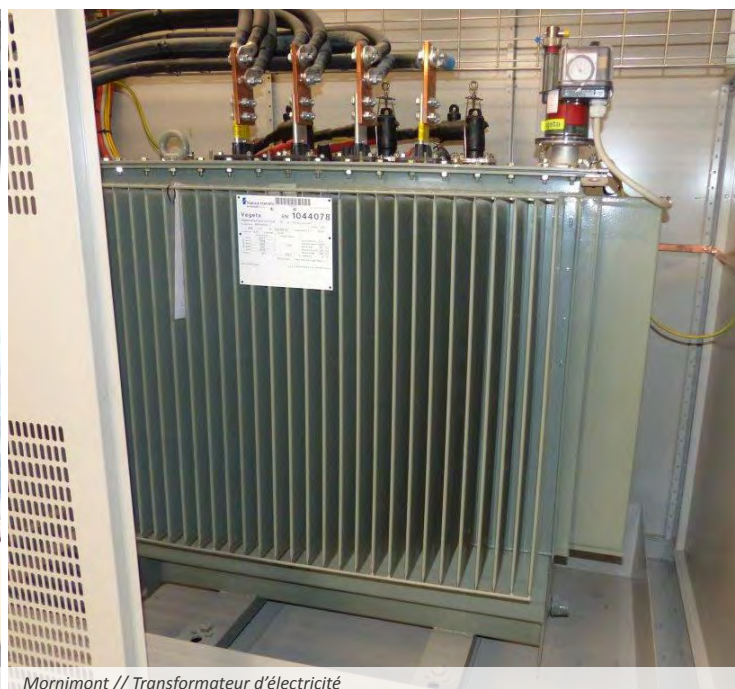
Mornimont // Transformateur d'électricité
