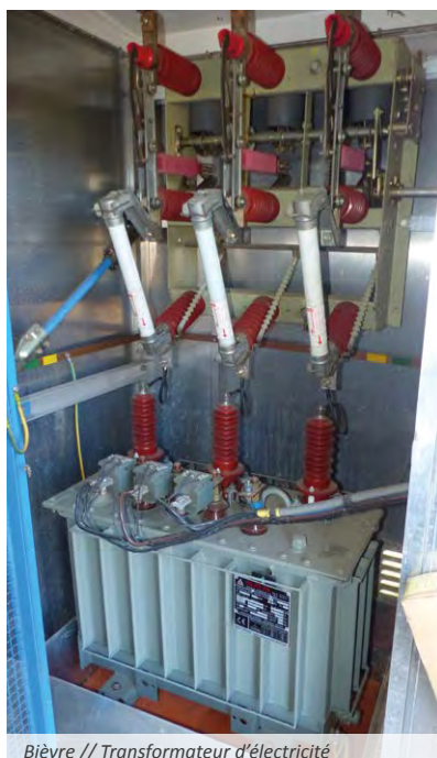
Bièvre // Transformateur d'électricité
