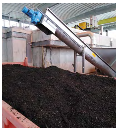
Mornimont // Sables récupérés en conteneur de l'unité de dessablage
