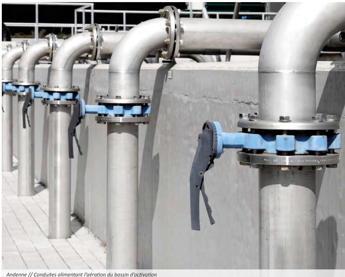
Andenne // Conduites alimentant l'aération du bassin d'activation
