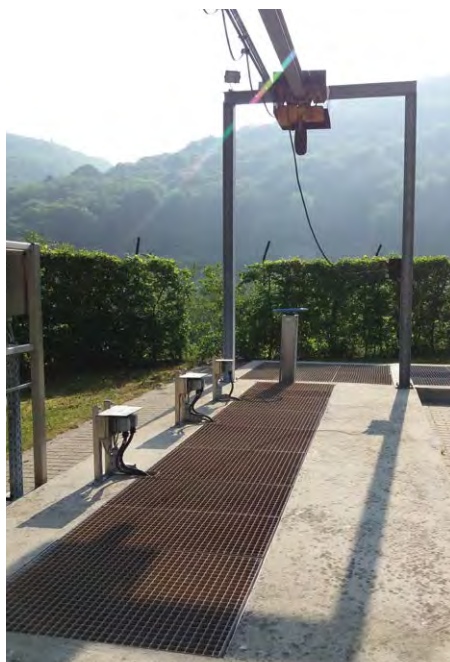
Wépion // Pompage relevage
