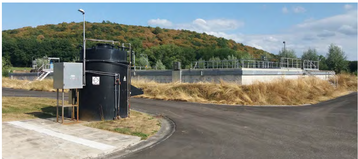
Couvin-Mariembourg // Cuve de chlorure ferrique
