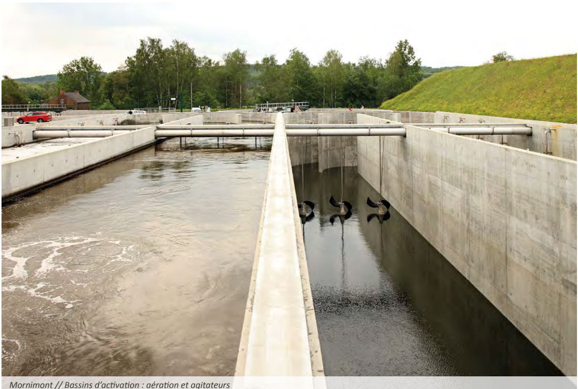
Mornimont // Bassins d'activation : aération et agitateurs
