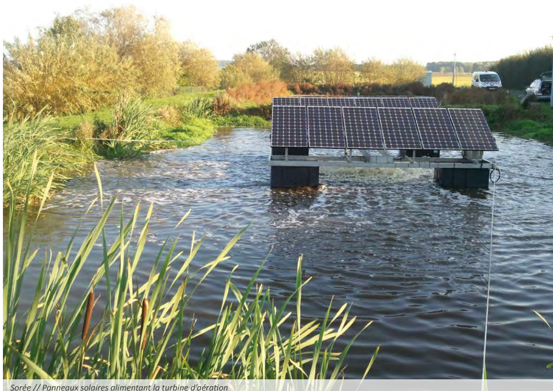
Sorée // Panneaux solaires alimentant la turbine d'aération
