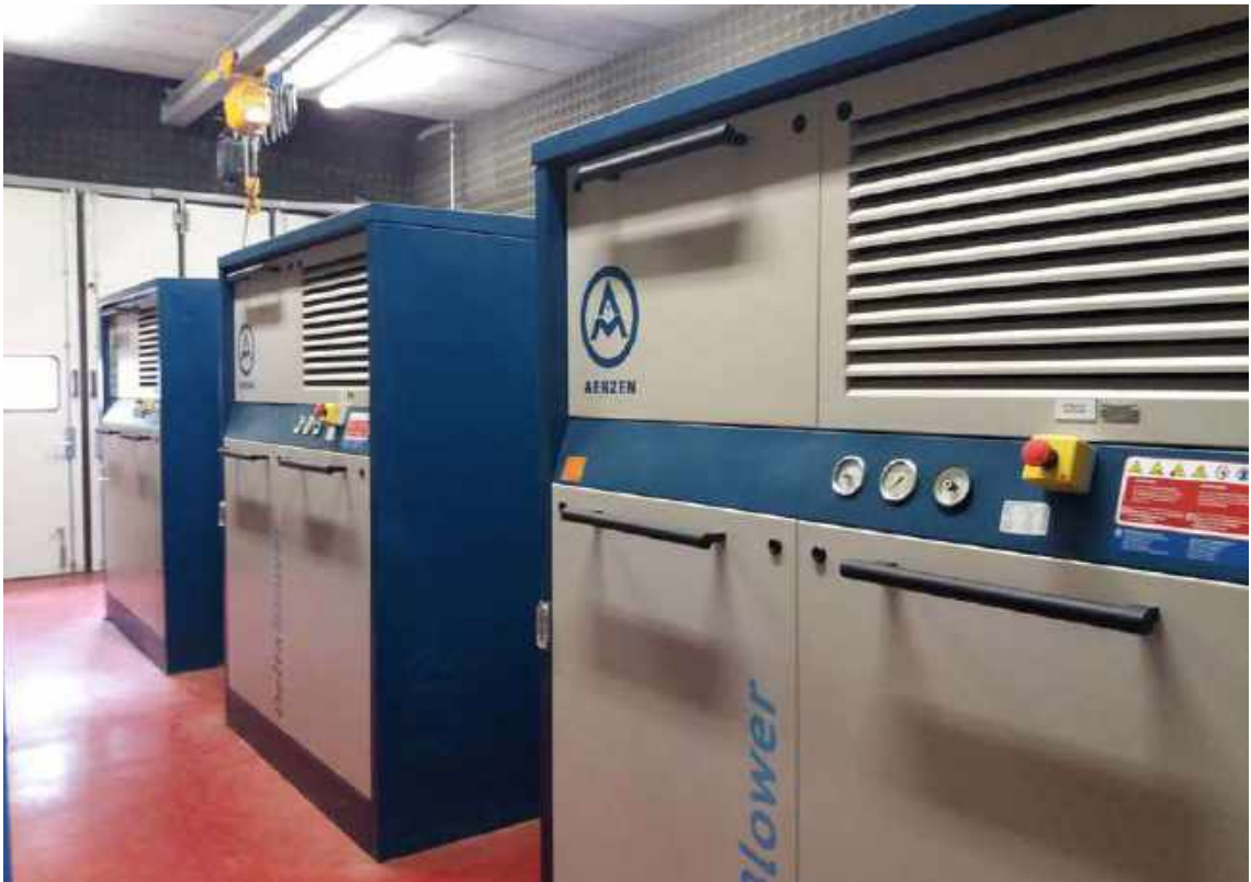
Wépion // Surpresseurs (principale source de consommation d'énergie pour l'aération des bassins d'activation)
