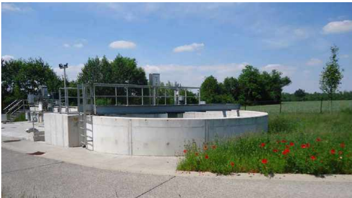
Pontillas (Gochenée) // Station d'épuration
