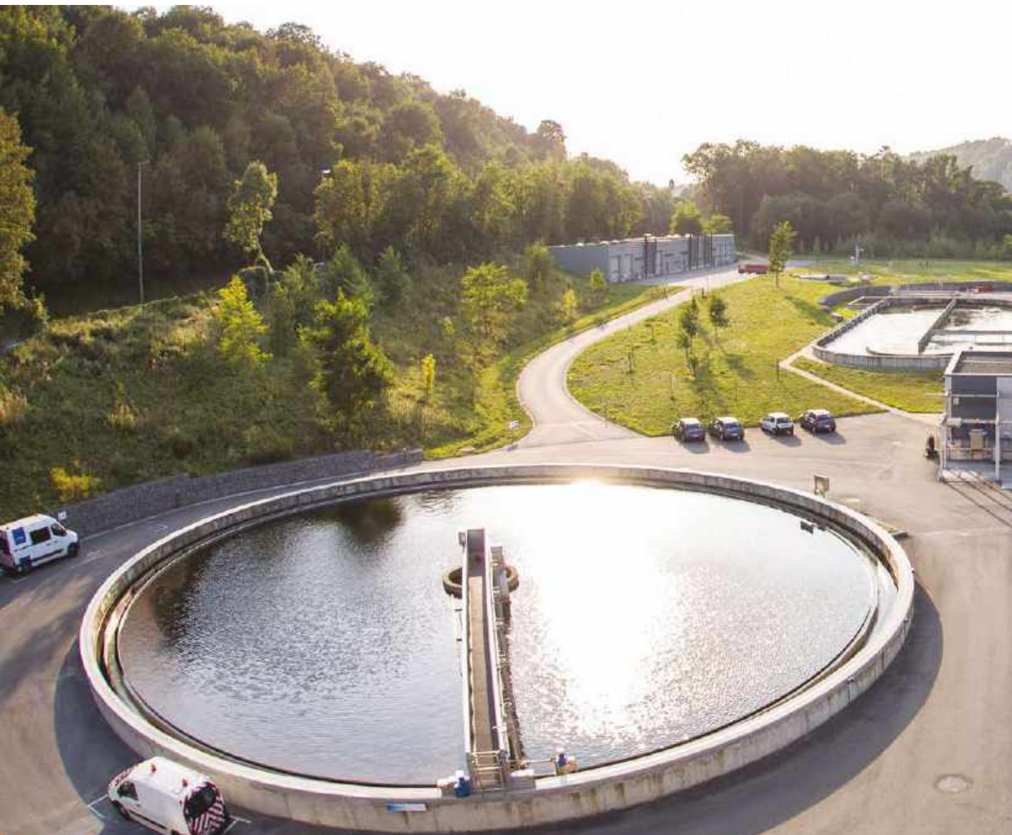
Lives-sur-Meuse // Station d'épuration
