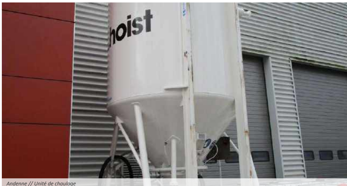
Andenne // Unité de chaulage
