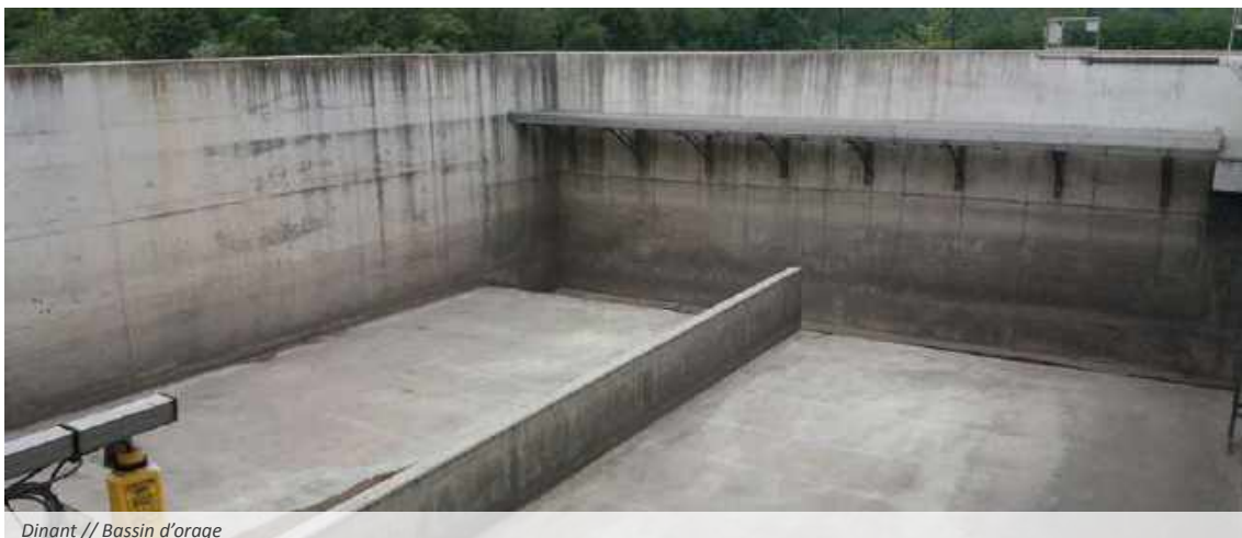
Dinant // Bassin d'orage
