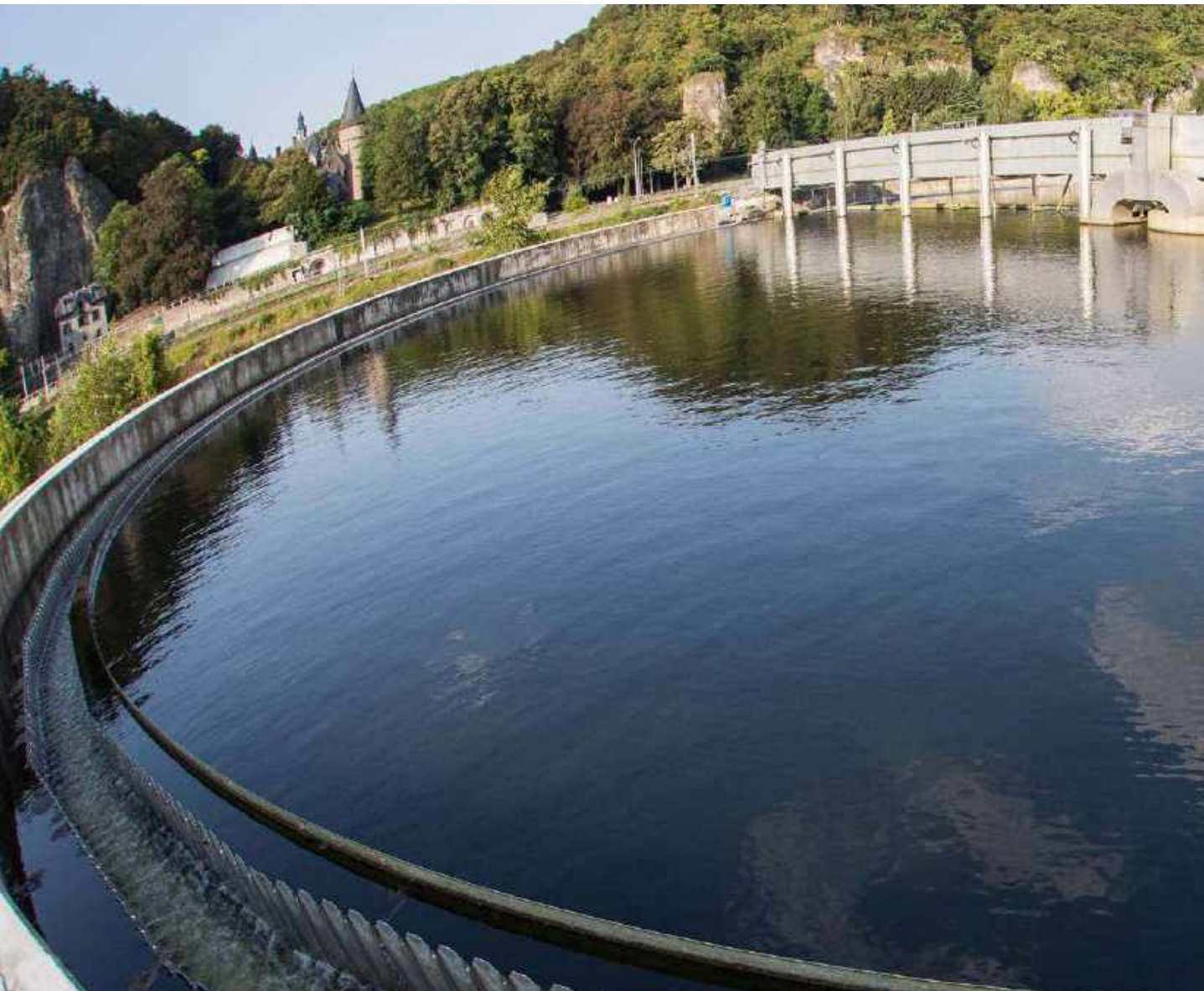
Lèves-sur-Meuse // Décanteur secondaire
